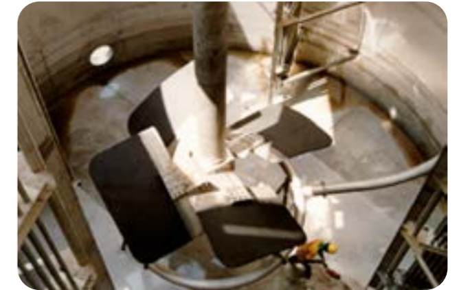
AGITADORES DE ENTRADA VERTICAL EN LA INDUSTRIA MINERA
