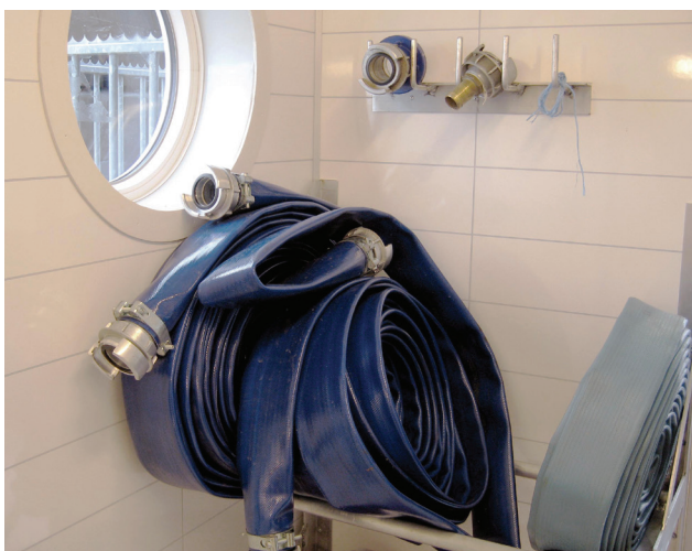
ANLEGGET ER UTSTYRT MED DRIKKEVANNSGODKJENTE SLANGER SOM SIKRER HYGIENISK VANNFORSYNING TIL SKIPENE.
