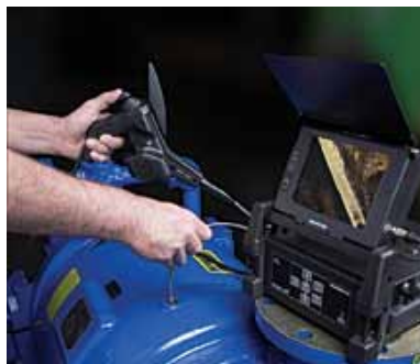
KONTROLL AV VAKUUMPUMPAR
