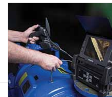
KONTROLL AV VAKUUMPUMPAR
