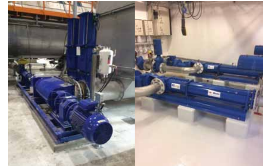
Mono EZstrip pump BIOFOS' reningsverk.
