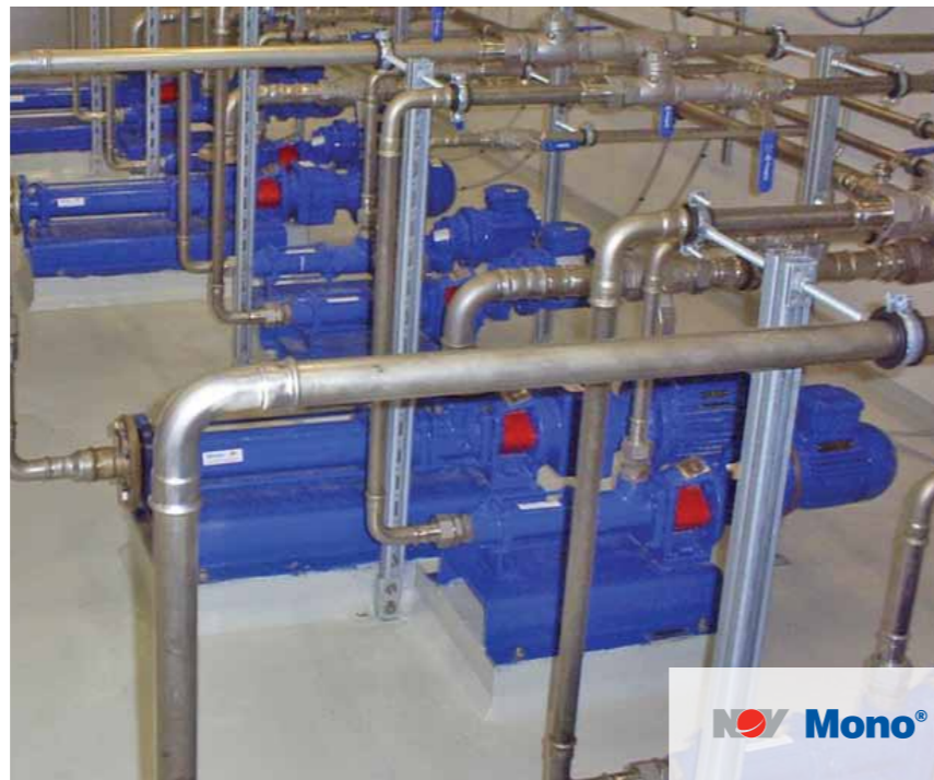
AVLOPPSRENINGSVRKT I ODENSE HAR VALT ETT ANTAL EZSTRIP PUMPAR OCH EXCENTERSKRUVPUMPAR FRÅN MONO. BESLUTET GRUNDADES PÅ PUMPARNAS REDUCERADE UNDERHÅLLSTID.
